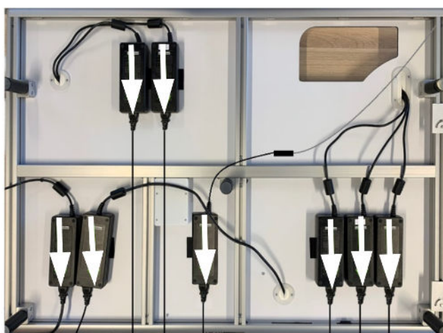
Figure 2-14 : Organisation des câbles
